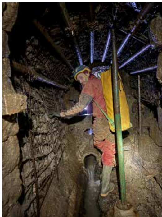
Trieste, condotta iniziale dell'Acquedotto Teresiano
