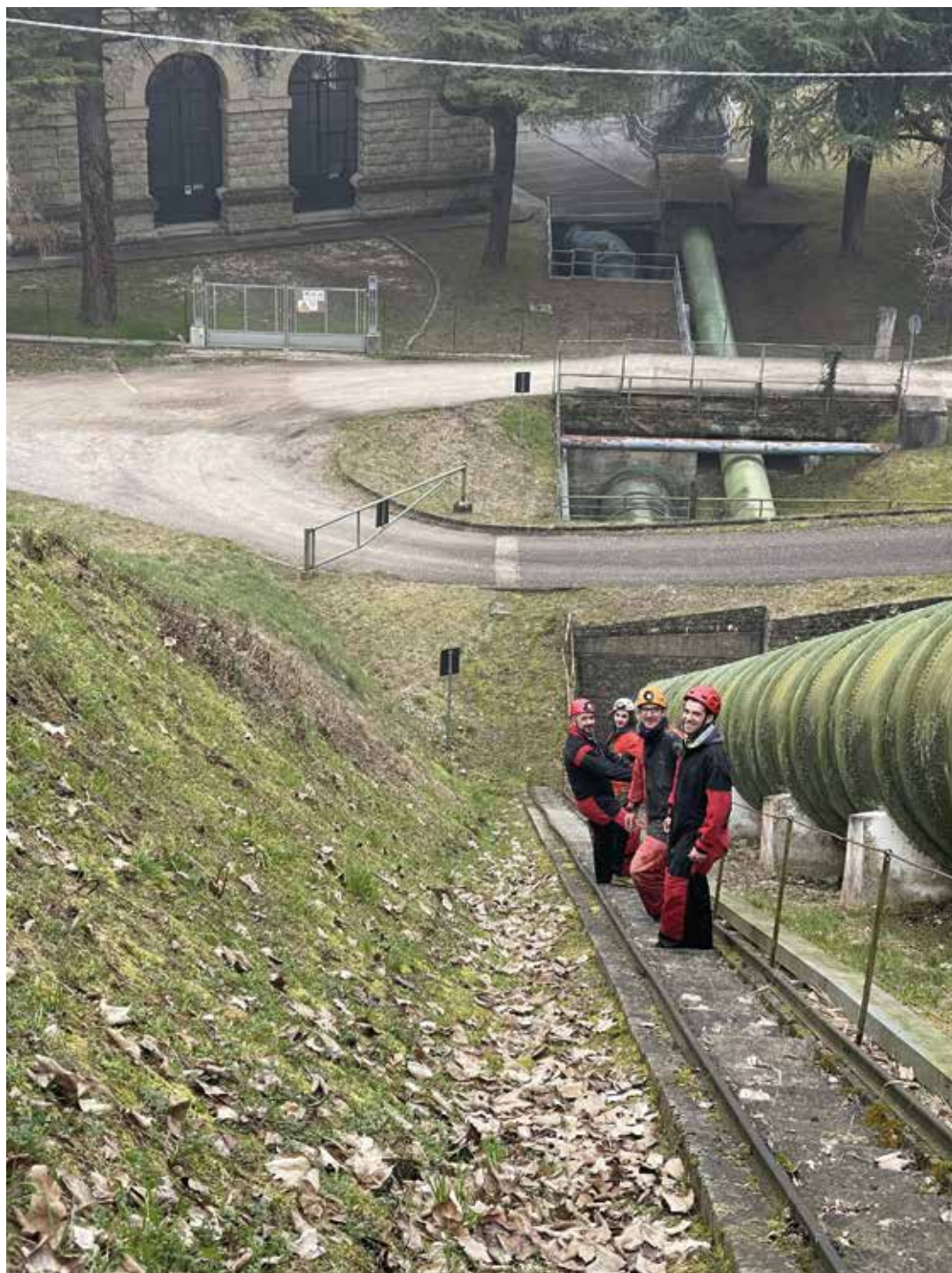
Condotte forzate che raccolgono l'acqua dal Canale di Castelviero fino alla centrale di Nervesa, foto Marcello Pellegrini
