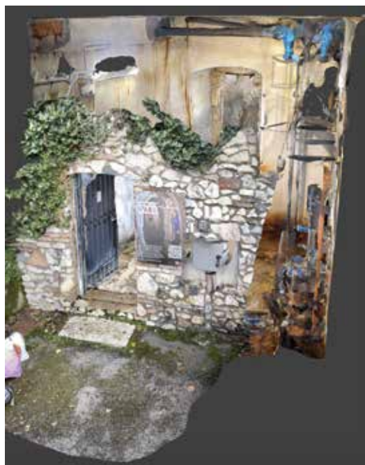
Ingresso zona pompe, Acquedotto La Bot (Asolo - TV), estratto da scansione fotogrammetrica, Marcello Pellegrini
