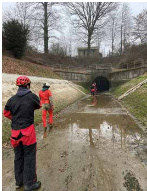
Canale di Castelviero, ingresso presa n°7, foto Marcello Pellegrini
